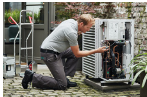
Mit Wärmepumpen kann man bei fachgerechter Planung und Installation jährlich bis zu 50 Prozent der Heizkosten sparen. Foto: Vaillant
