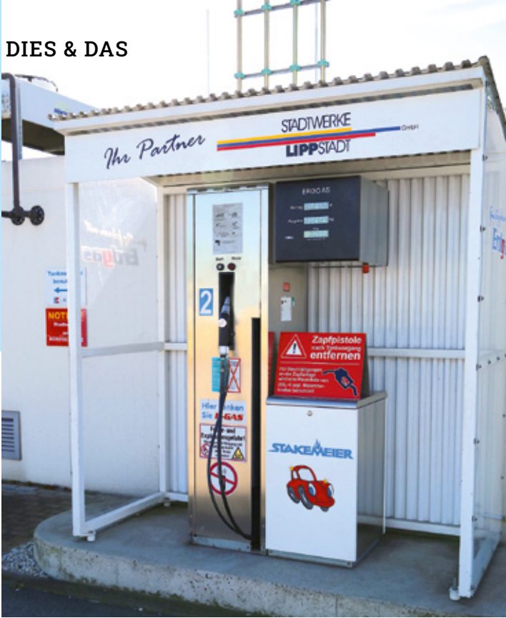
In Kooperation mit den Stadtwerken Lippstadt entstand 2008 diese Erdgastankstelle. Fotos: Wittmers
